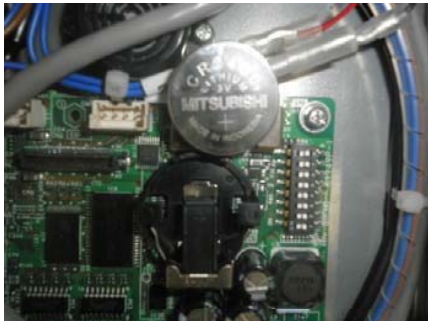
(電池を取り外したところ)
